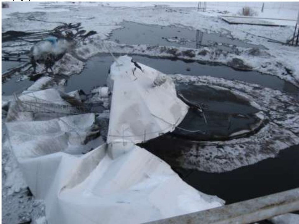
Рис. 2. Общий вид разрушения РВС-700 №49.
