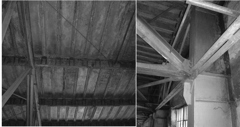
Рис. 2. Коррозионные повреждения конструкций покрытия цеха
